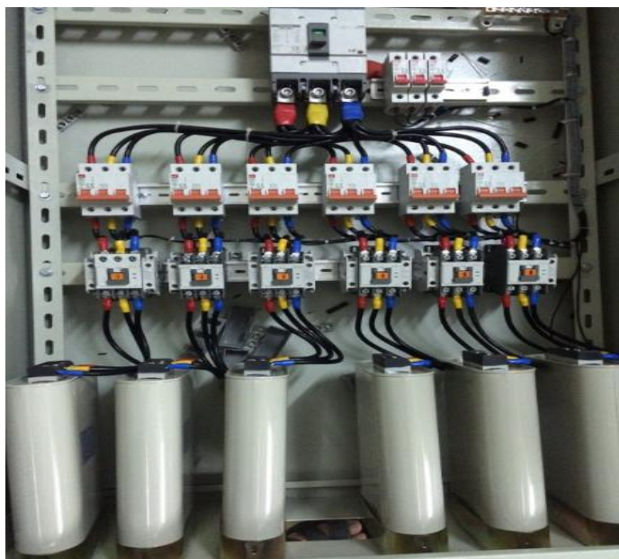
Hình 8.5. Tủ bù công suất phản kháng
