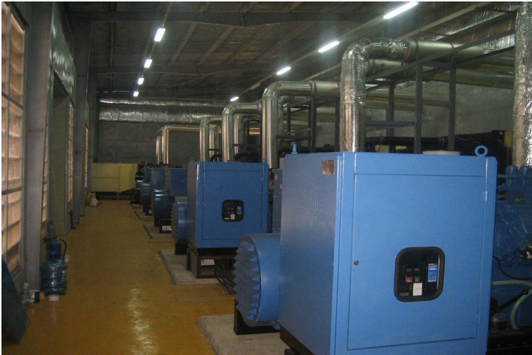
Hình 1-8: Nhà đặt máy phát điện
