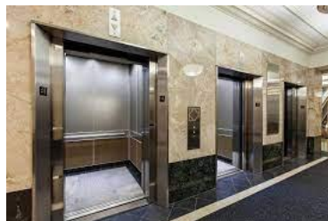
Hình 1.8. Hệ thống thang máy
